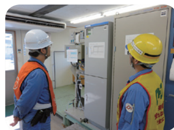
環境重点設備点検(星崎工場)
