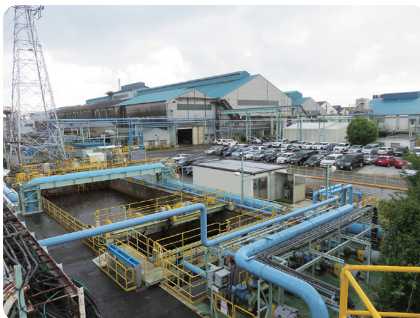
星崎工場排水処理
